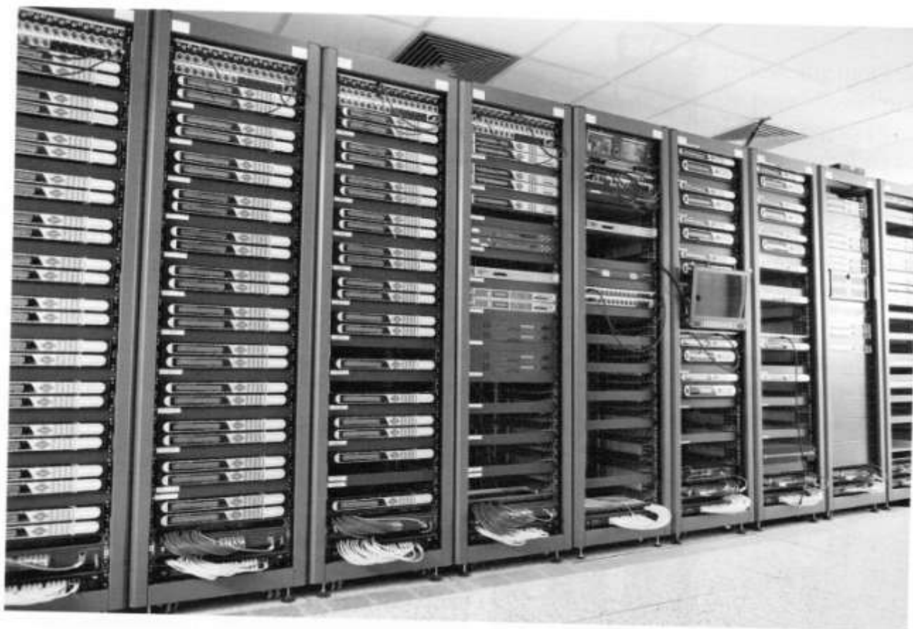
Rys. 102.3. Przykładowa szafa RACK z serwerami i wyposażeniem
