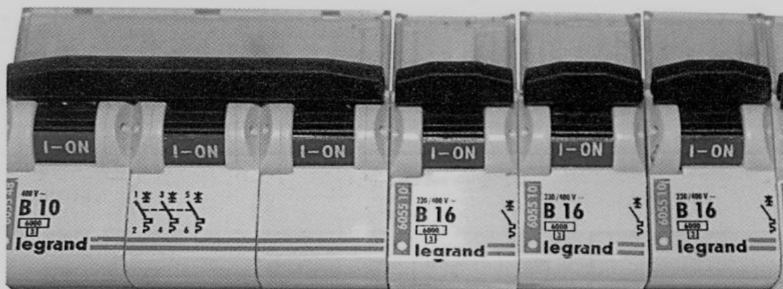
Rys. 8.3. Wyłącznik nadmiaroprądowy 3-fazowy 10 A (po lewej) i trzy wyłączniki 16 A (po prawej)
